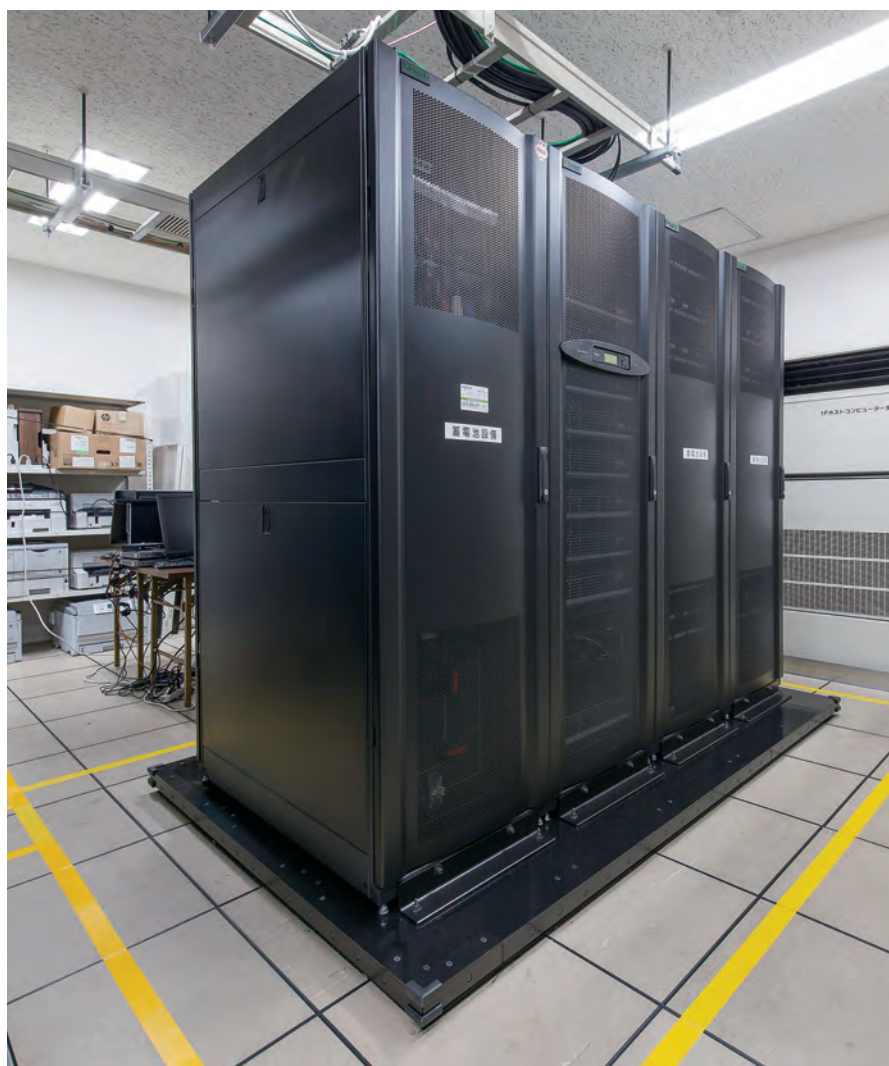
済生会熊本病院(サーバーラック)
