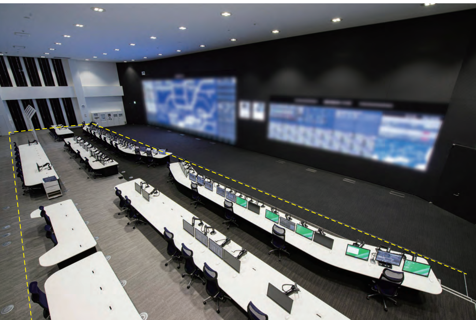
道路管制センター（施工面積281㎡）
