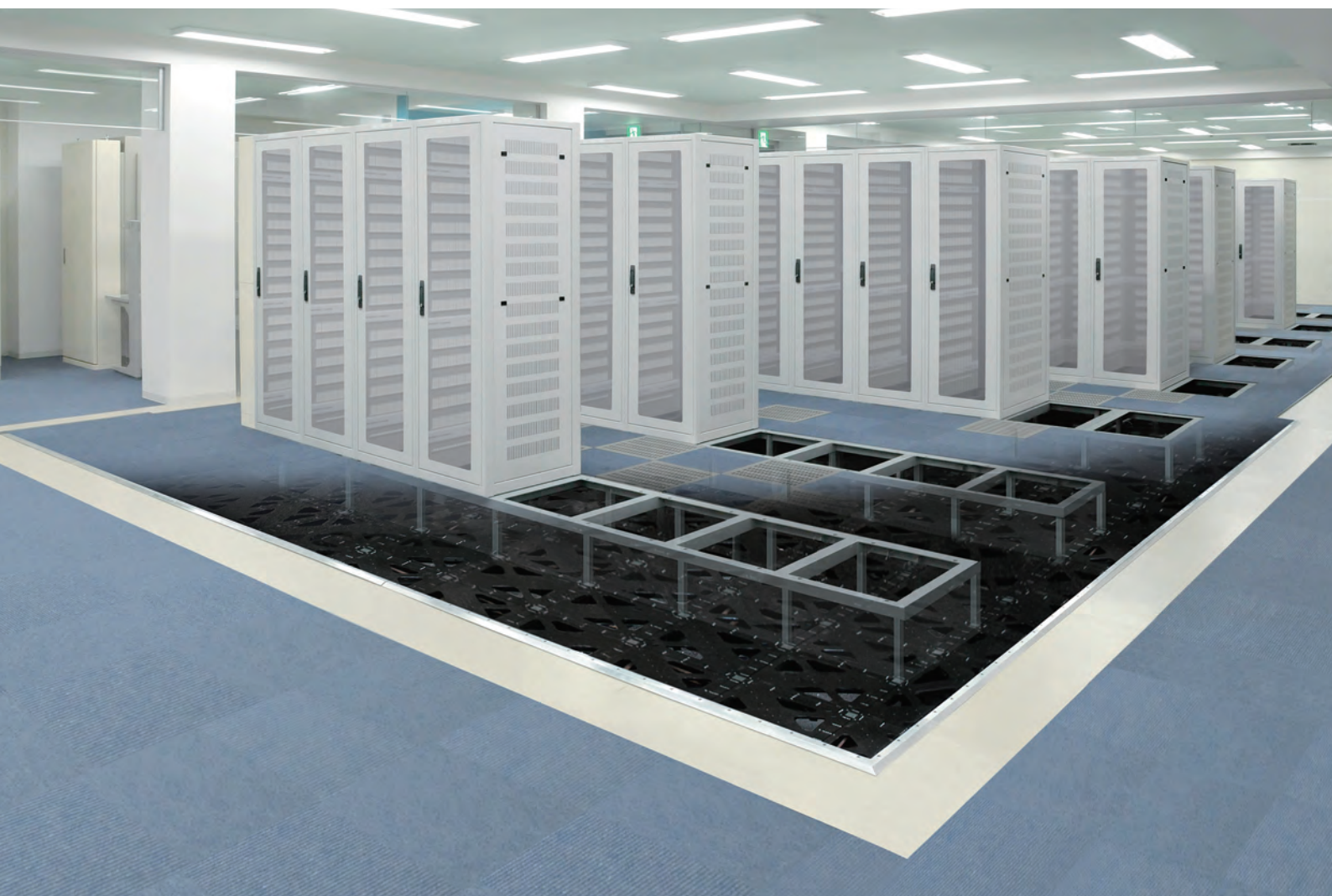
豊橋ケーブルネットワーク株式会社(データセンター)
