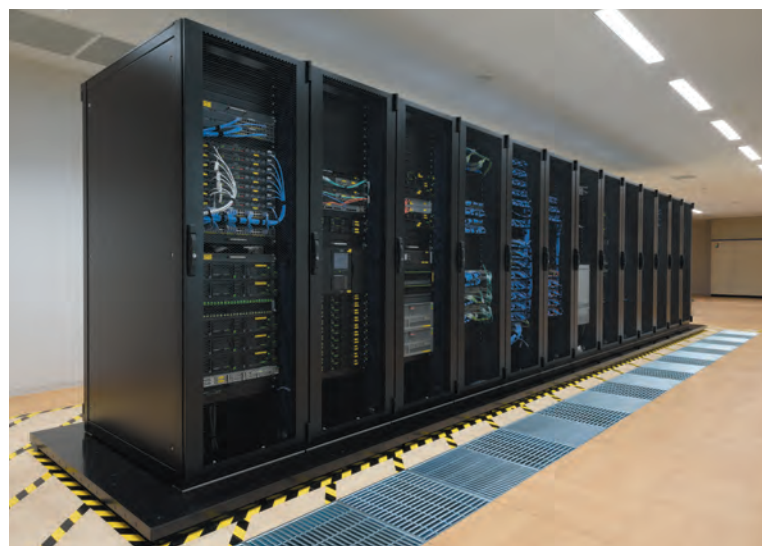
免震モジュール TGS 型を設置したサーバー
